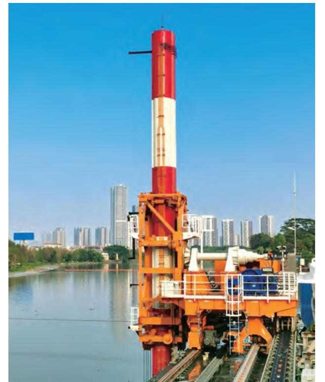
内河沉管整平装备
