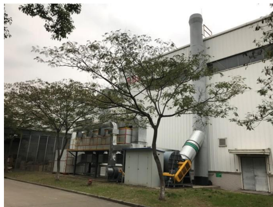
二车间VOCs处理装置
