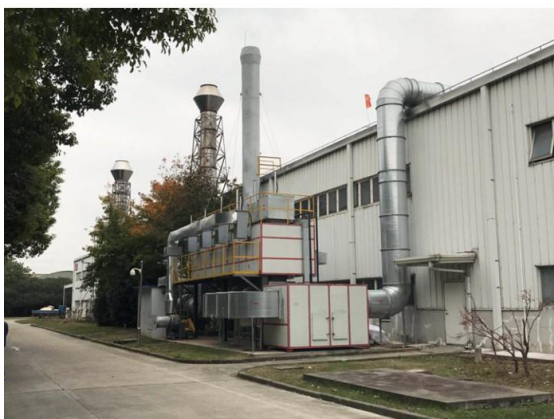
一车间VOCs处理装置
