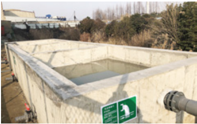
升级改造后的污水排口隔断系统。
