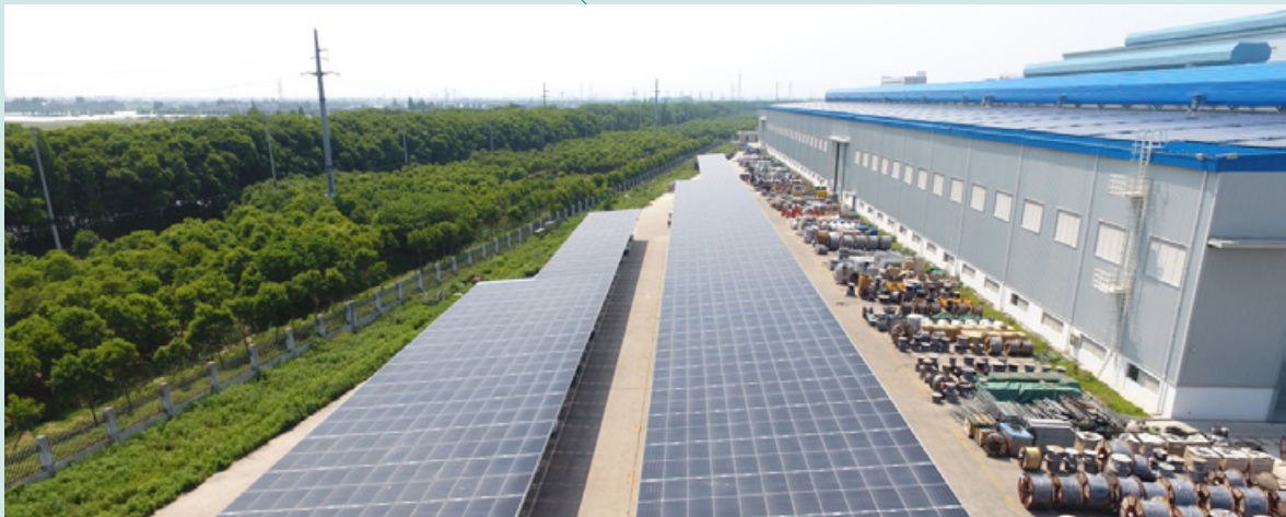
振华重工光伏车棚项目。
